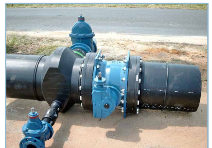
Kreuzstück, Projekt in Deutschland Cross, project in Germany
