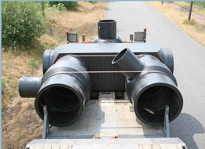
Verteiler, Projekt in Malta Distributor, project in Malta
