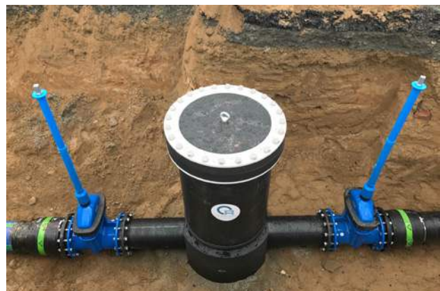
Bild 5: Quick-Pig-Molchschleuse eingebaut in der Zuführung zum Wasserwerk Radelandberg Nord
