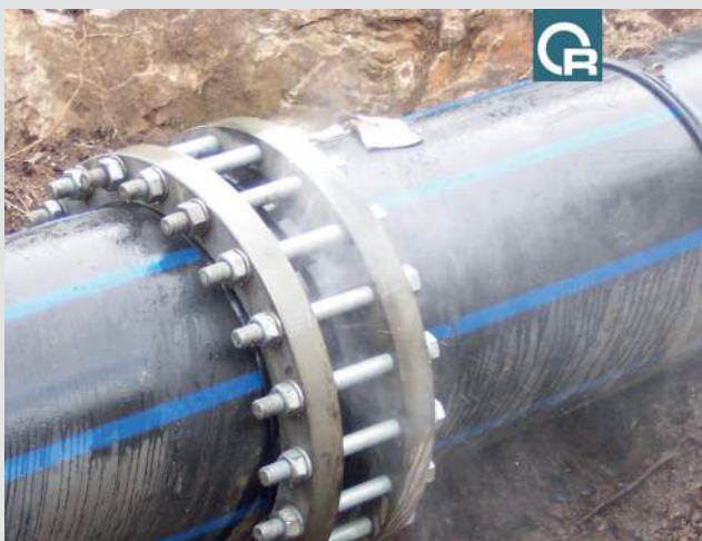
Bild 1: Undichtigkeit einer DN 600 Druckrohrleitung
